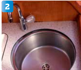
2 Den nya sjövattnenkranen ska monteras i hörnet till höger om diskhon och den befintliga färskvattnenkranen.
