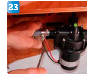
23 Tryckvattenpumpens placering är optimal. Ovanför skyddas den av en träpanel. Slangen från kranen skruvas fast i pumpen. Vid varje slanganslutning ska två slangklämmor användas.
