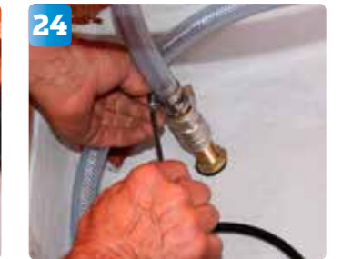
24 Nästa steg är skruva fast den tjockare slangen, med dubbla slangklämmor, som ska löpa från sjövatteintagetets kulventil till pumpen.
