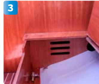
3 Det gäller att finna en lämplig plats att montera tryckvattenpumpen. Under babordssoffan, där det finns ett rejält stuvutrymme, passar perfekt. Avståndet mellan kran och pump blir då drygt en meter.
