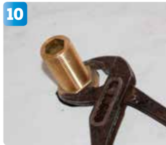
10 Genomföringens mutter dras fast försiktigt med en polygrip. På utsidan håller en medhjälpare emot. Om genomföringen snurrar förlorar tätningen sin funktion. Massan måste torka några dagar innan överflödiga massan kan skäras bort.
