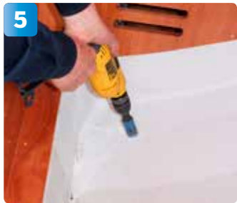
5 Genomföringen har en diameter på 19 millimeter. Med hålsåg borrar proffsinstallatören Bob Nabb ett 21 millimeters hål. Det är viktigt för att tätningssmassan ska kunna tätas mellan skrovet och genomföringen.
