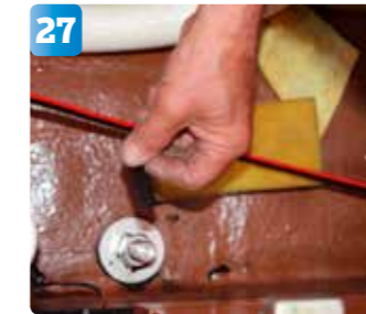
27 Sedan är det dags att dra elkablar från tryckvattenpumpen via kölsvinet upp till elcentralen. Det behövs drygt fyra meter kabel. Kabelarean är 4 mm². En tumregel är att öka kabelarean med en kvadrat per löpmeter kabel som används.
