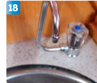
18 Den nya kranen monteras. Lite silikon mellan skivan och kranen skyddar mot inträngande vatten.
