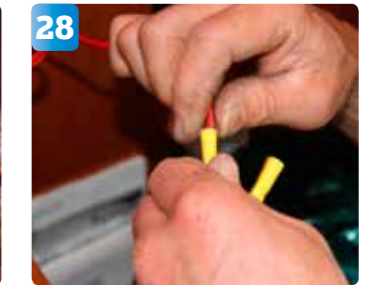
28 Kablarna från pumpen dras fram bakom panelen intill navigationsbordet. Skarvhylsor behövs.
