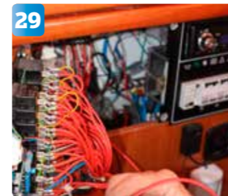
29 Kablarna kopplas in i panelen där både plus och minus finns.
